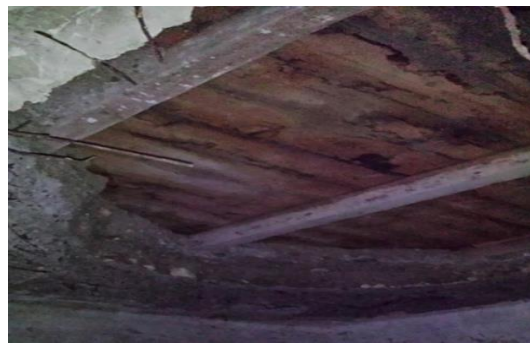
Slika 3. Urušen deo ploče iznad prizemlja
