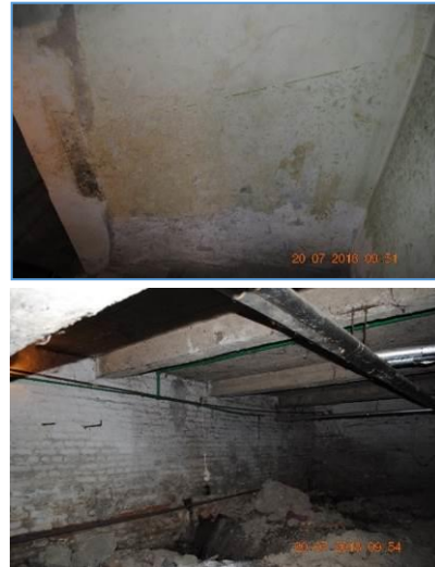
Slika 6. Mrlje od kapilarnog upijanja vlage-zid u osi 3 (gore) i kristalizacija soli u podrumu-zid u osi 2(dole)
