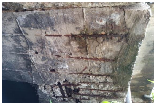
Slika 10. Defekti i oštećenja na spoju poprečnog i podužnog nosača
