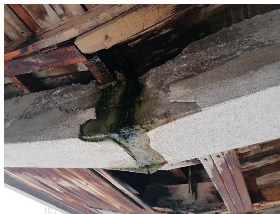
Slika 7. Oštećenja noseće AB grede
