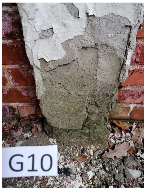
Slika 6. Oštećenja AB stuba G10
